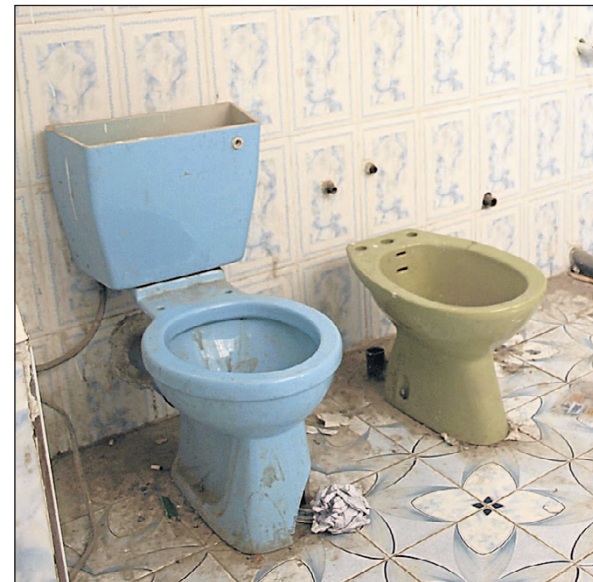
Wie wichtig es ist, Installateure auszubilden, zeigt eine Toilette in der Berufsschule.
